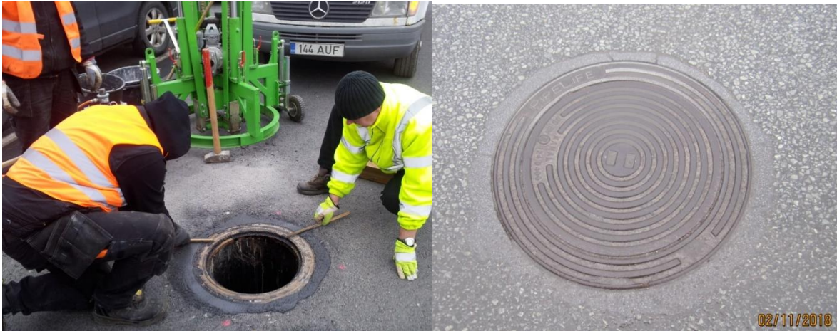
Foto 22-23. Kaevupäise ümbruse täitmine Vergumix seguga Kotka tn 2016.a. Vergumix-segu on pragunenud (2018)
