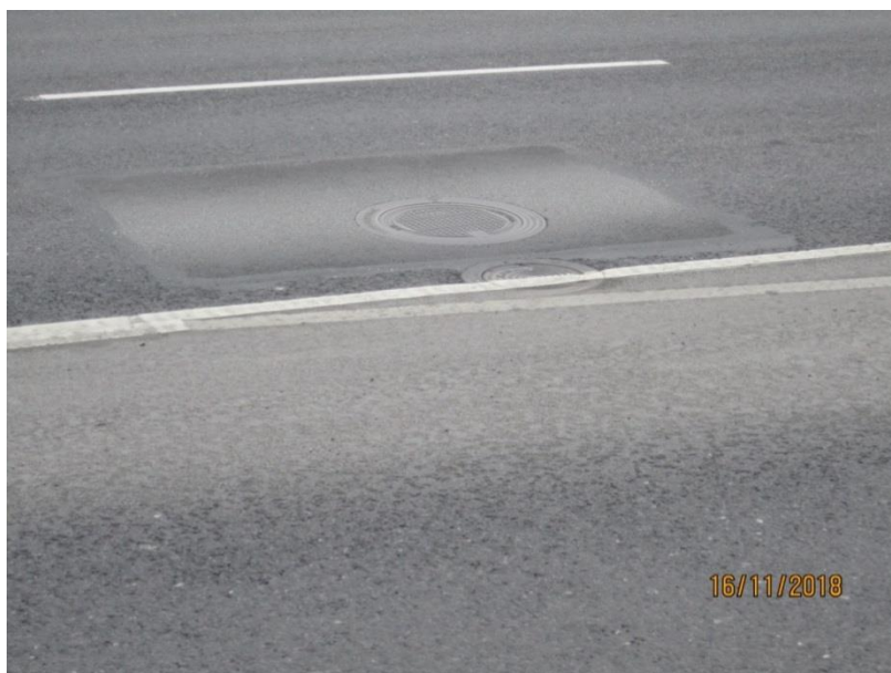
Foto 26. Tammsaare tee 2018.a kaev Pärnu mnt viadukti all
