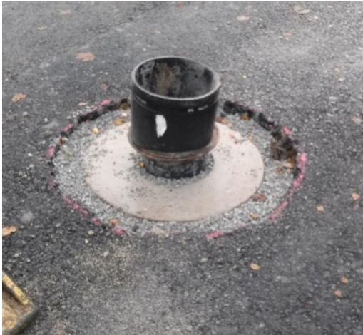
Foto 21. Paigaldatud koormusjaotusplaat Kotka tn 2016.a. Teleskooptoru koos luugikomplektiga on eemaldatud.
