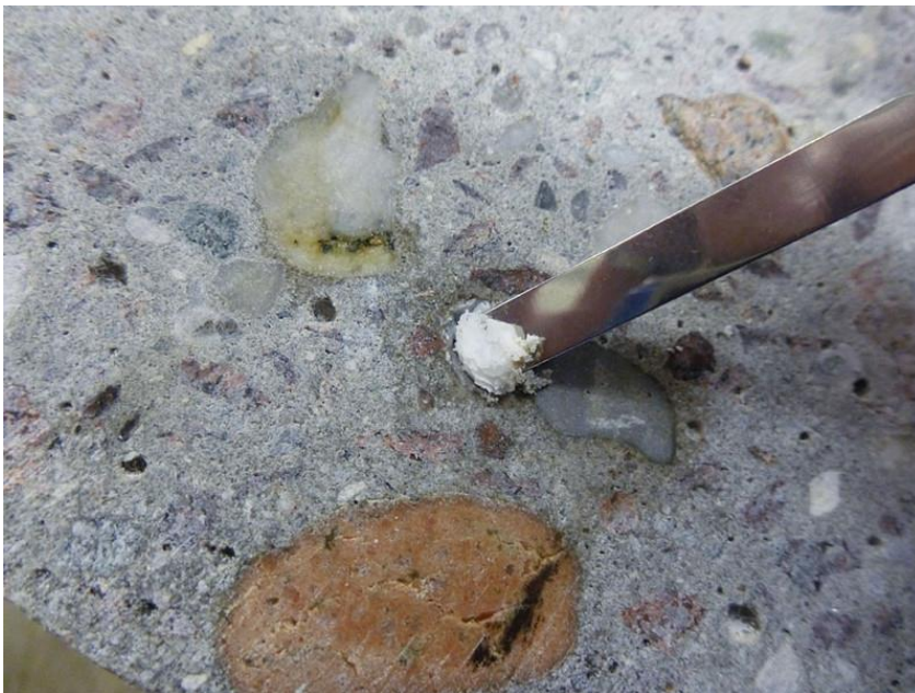
Foto 4. Alkali-silica reaktsioon betoonis 14
