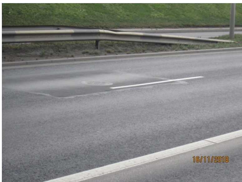
Foto 27. Tammsaare tee 2018.a kaev Pärnu mnt viadukti all
