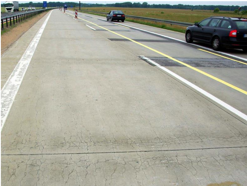
Foto 3. Alkali-silica reaktsiooni tagajärg 13
