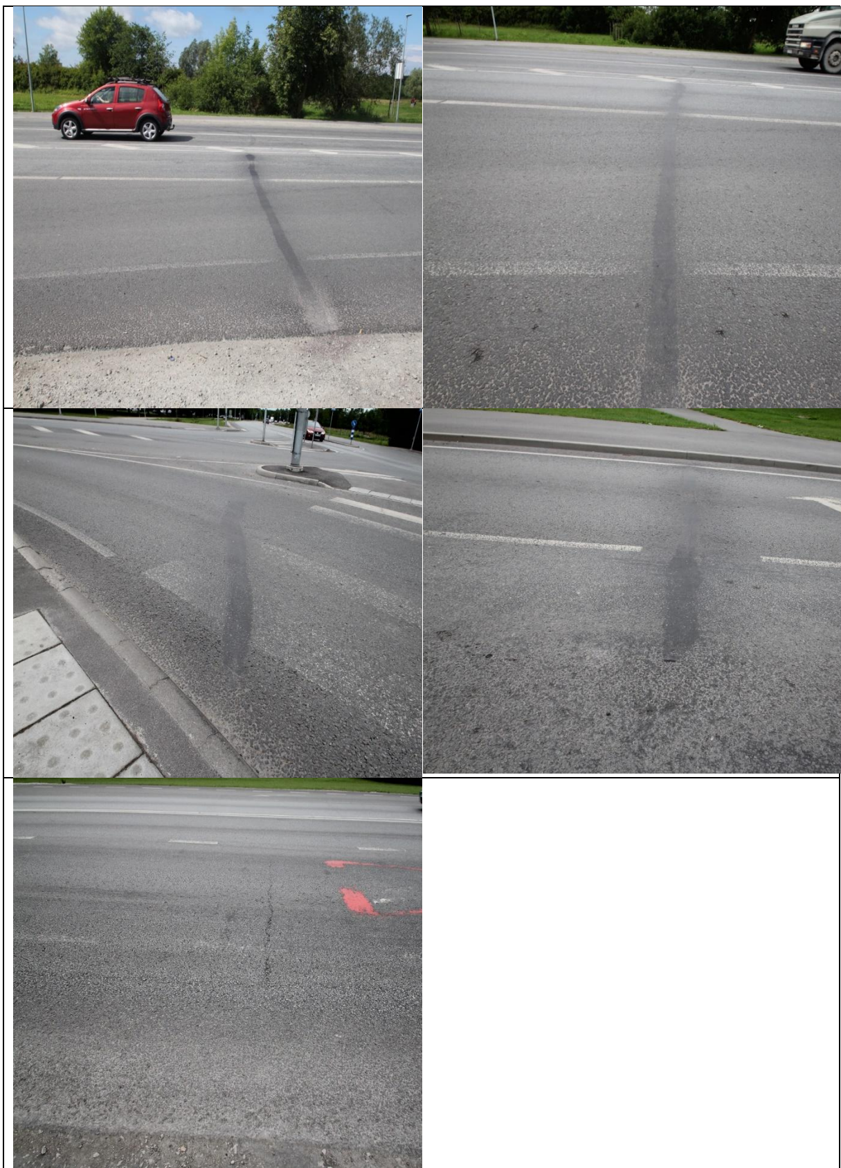
Joonis 8.5. Asfaltbetoonist kulumiskihiga betoonkattes tekkinud praod
