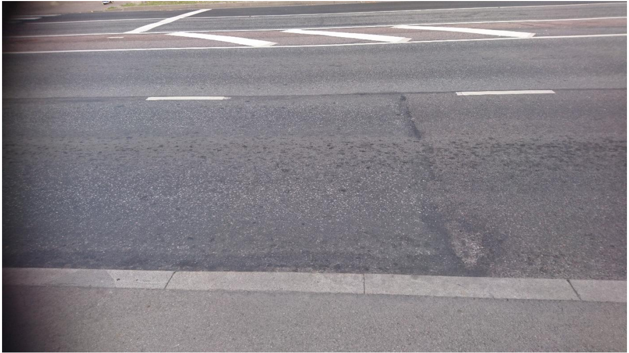
Foto 1.7.1 Vaade Sõle bussipeatuse kesklinna suuna katendile. On tuvastatav bussipeatuse keskme poole jääv vuugivahe, ning äärekivi lähedases servas katendi kulumine (vt võrdlusjoonist, sööri alumine osa), küll aga visuaalsel vaatlusel tõusudeformatsioonid (suurusjärgus 5...10 mm) ei ole tuvastatavad. Ilmselt on tegemist masside ümberpaiknemisega katendialuses kihis.
