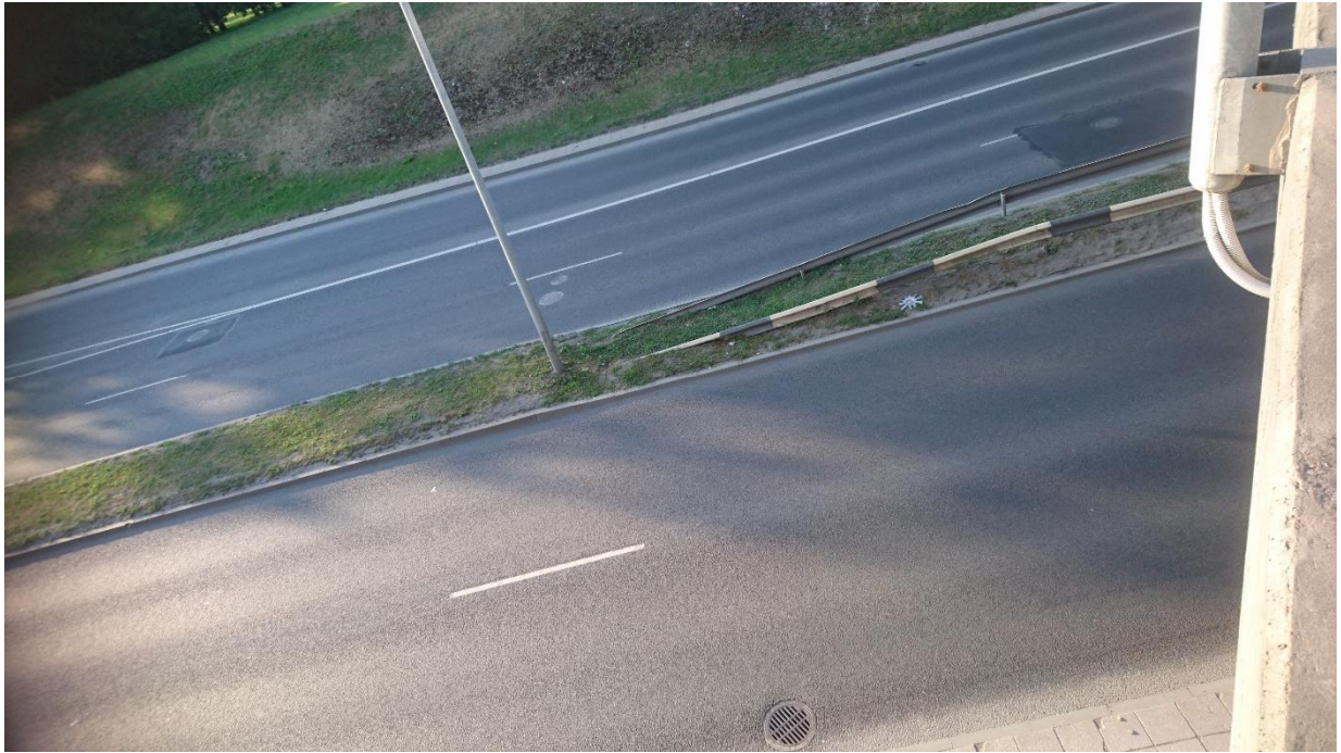
Foto 1.9.1 vaade viaduktilt Tondi suunas. Foto allosas kaev on vajunud, vastassõidusuunal on nähtavad kaevuümbruse katendiparandused.
