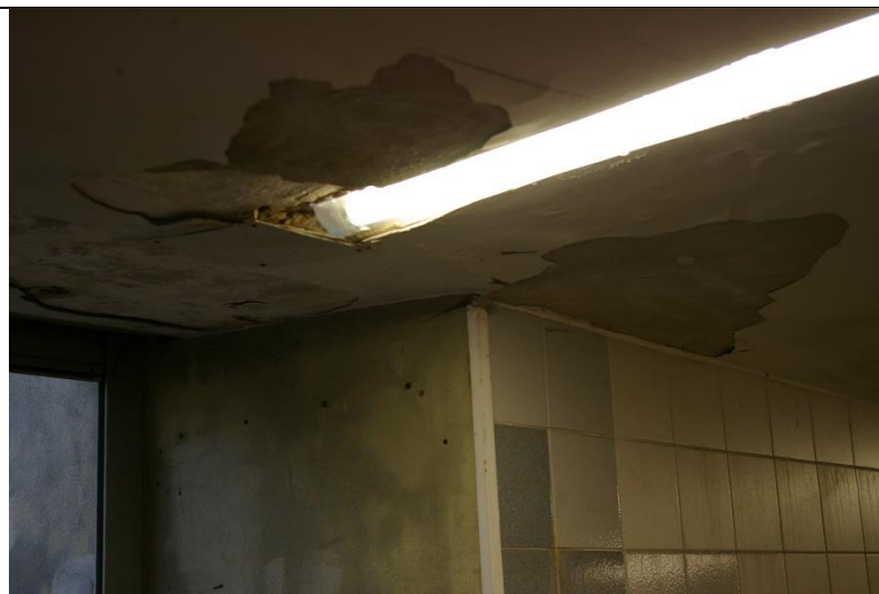
Hüdroisolatsiooni lekked põhjustavad betooni kahjustusi
