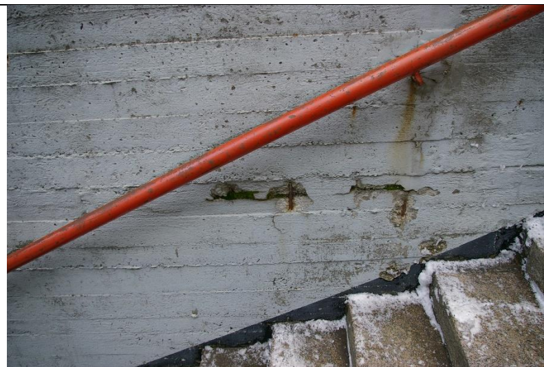
Käsi puud roostes, tugimüüri kahjustused
