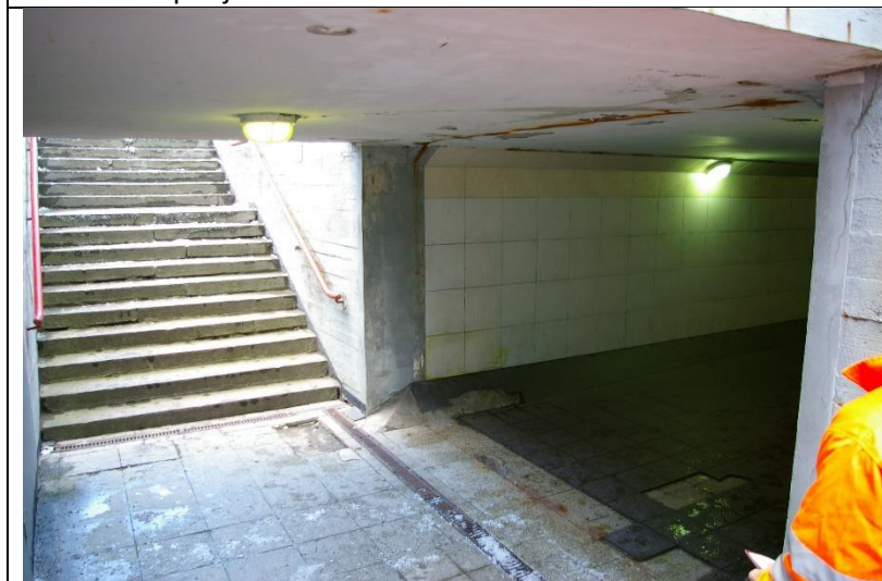
Hüdroisolatsiooni lekked, kõnnitee plaadid lagunenu
