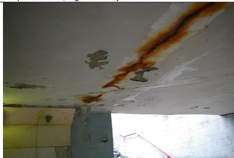
Vee lekete poolt põhjustatud plaadi kahjustused
