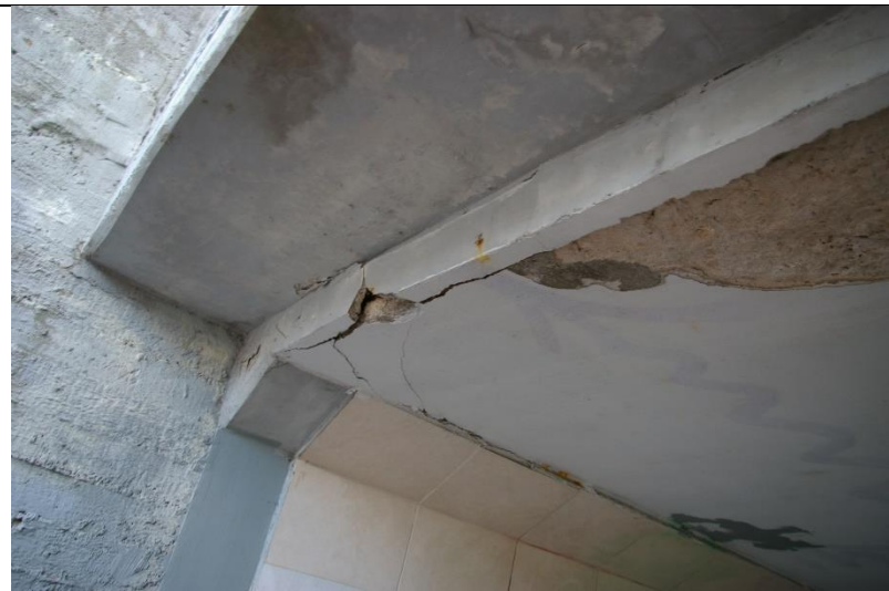
Betooni tükide pudenemise oht
