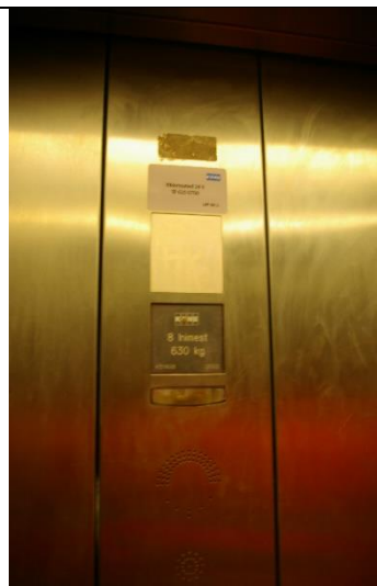
Lifti nr.3 järgmise hoolduse kleebis on puudu
