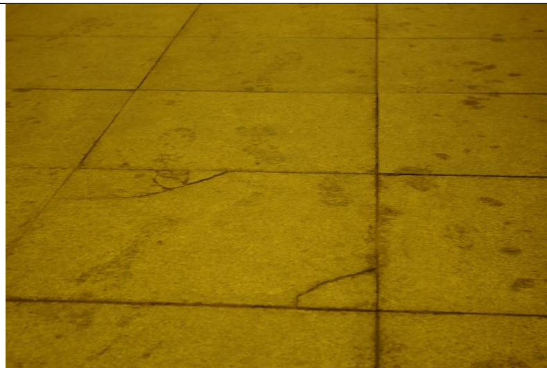
Kõnnitee plaadid osaliselt purunenud
