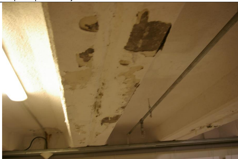
Hüdroisolatsiooni lekked põhjustavad betooni kahjustusi
