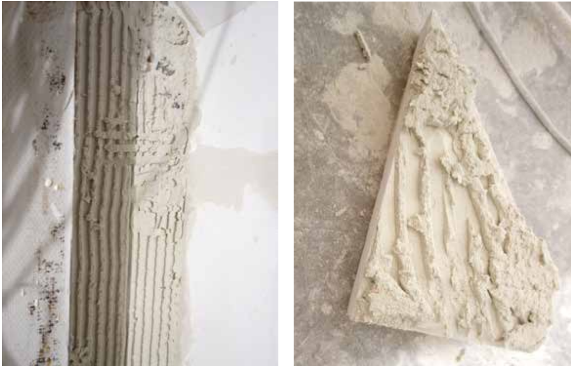
Joonis 15 CaSi soojustus tuleb selle korrektseks toimimiseks paigaldada ilma õhkvaheta – antud juhul on liimsegu liiga kaua kokkusegatuna seisnud ning muutunud liiga jäigaks.
