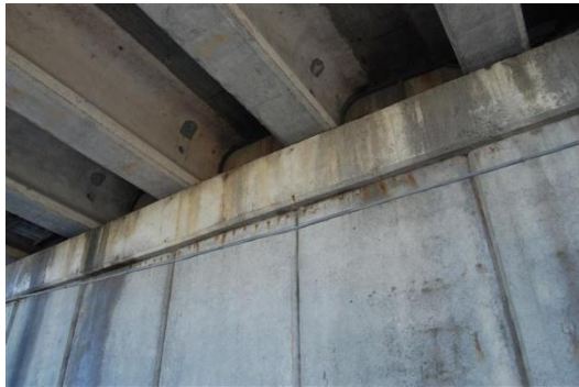
Vuugi leke on põhjustanud armatuuri paljandumist ja roostetamist.
