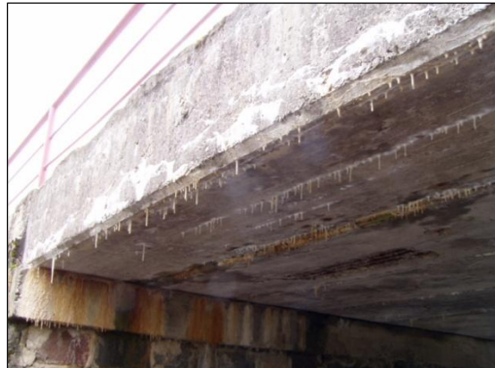
Hüdroisolatsioon lekib. Sillaplaadi kahjustused.
