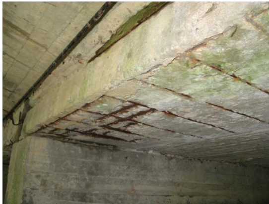
Silla plaadi armatuur paljandunud.
