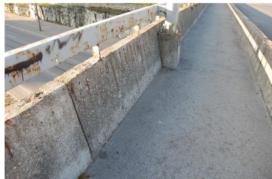
Kõnnitee plokkidel armatuur paljandunud
