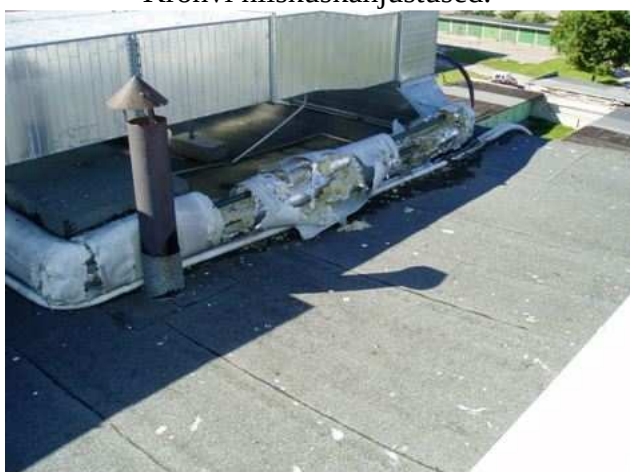
Ventilatsioonikalarifeeri kütetorustiku isolatsioon kahjustatud.
