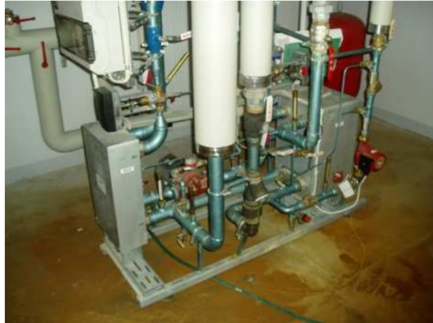
Joonis 20.3 Soojussõlme torustik isoleerimata.
