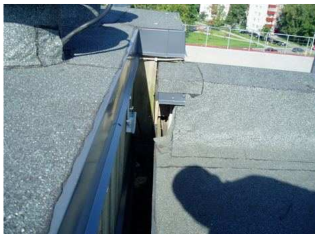
Parapeti liitekoht on lahti ja sademed pääsevad konstruktsiooni.
