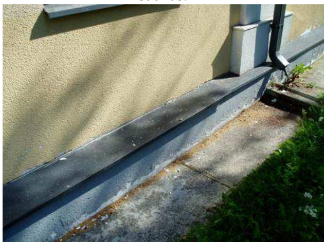
Seina soojustuse ja soklipleki vahele on tekkinud pragu.
