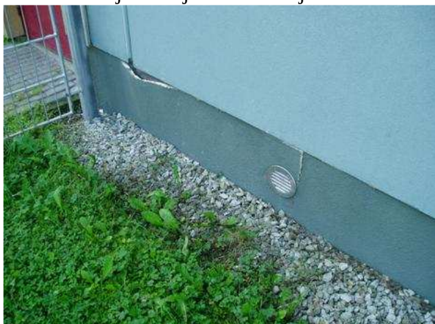
Sokli soojustuse kahjustus.
