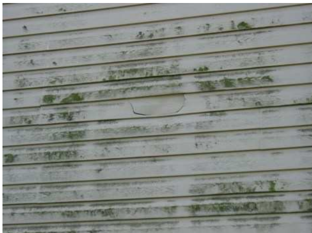
Põhjaseina sammaldumine ja fassaadikattes auk.
