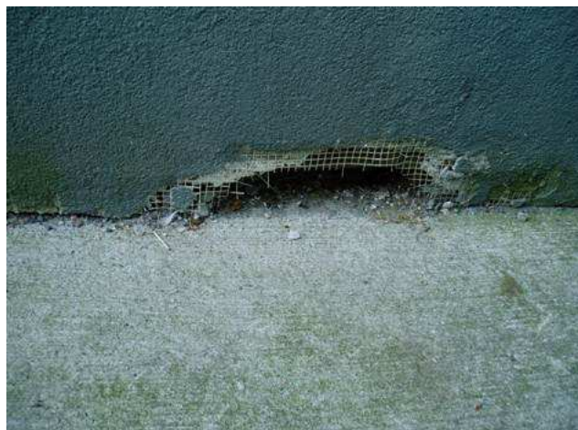
Soklikrohvi- ja soojustuse kahjustus.
