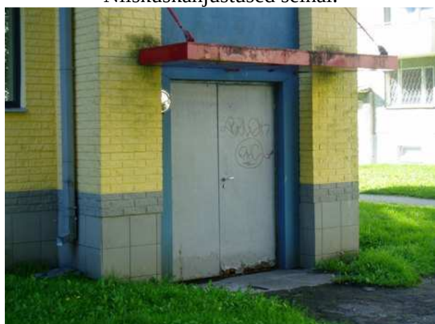
Niiskuskahjustused seinal. Variaktus ja uks on kohati läbi roostetanud.
