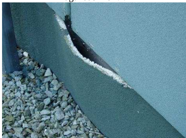
Sokli soojustuse kahjustus.
