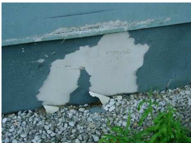
Soojustuse ja niiskuskahjustus.
