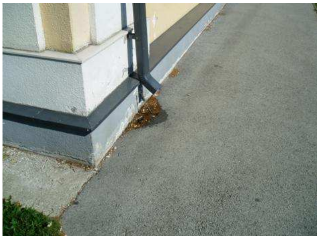
Krohvikahjustused ja vihmavesi valgub sokli suunas.
