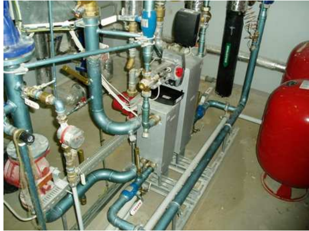
Joonis 8.3 Soojussõlme torustik isoleerimata.
