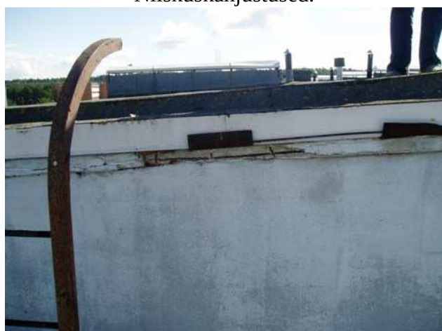
Katusel betoonarmatuur väljas.
