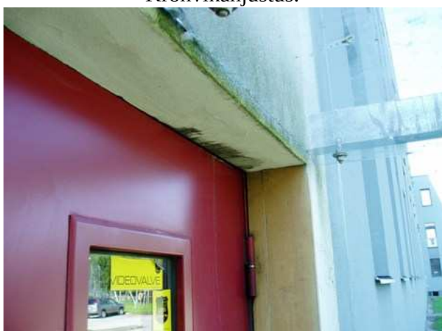
Niiskuskahjustused. Uks ei avane korralikult.
