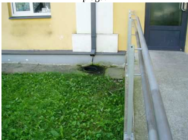
Soklil niiskuskahjustused, mis lagundavad seina.
