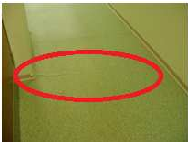
Mitmes kohas on näha koridorides põrandas pildil toodud kahjustusi.
