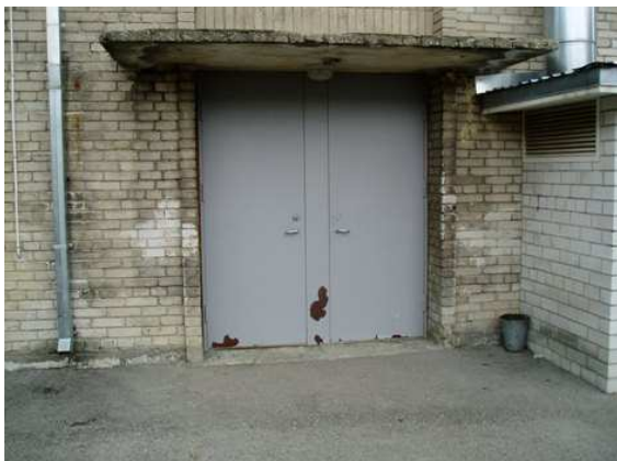
Varikatuse armatuur on väljas ja betoon lagunenu. Ilmastiku toimel armatuur roostetab ja lagundab betooni, mistõttu võib varikatus varisemisohhtlikuks muutuda. Välisuksel värvikahjustused ja uks roostetab.
