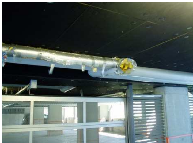
Maja all parklas kulgeva vee toru isolatsioon on kahjustunud, mistõttu esineb talvel vee jäätumist.
