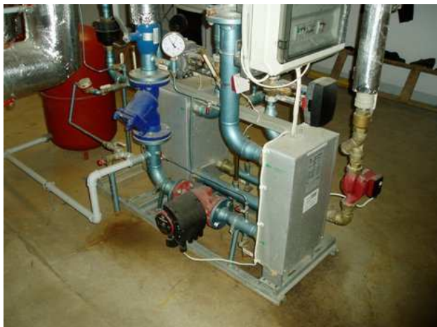
Joonis 19.2 Soojussõlme torustik isoleerimata.
