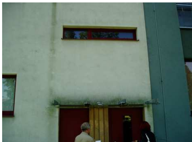
Variaktuse tõttu niiskuskahjustused seinal.
