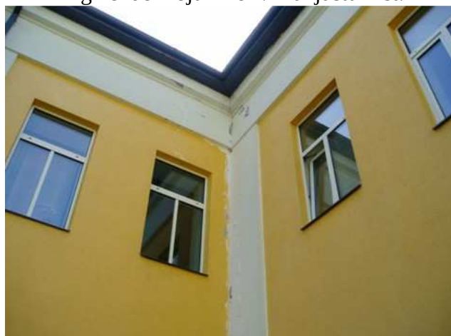
Sisehoovi nurk, kus on probleeme niiskuskahjustustega.
