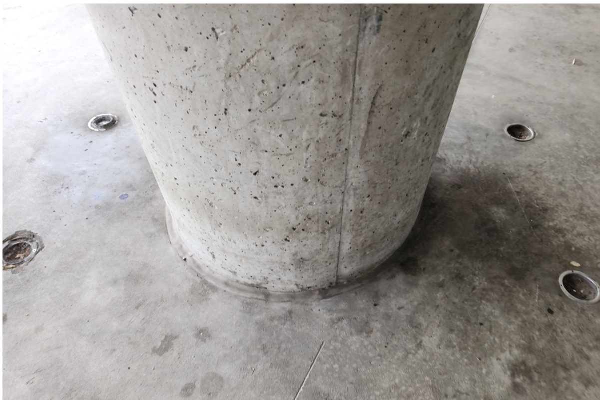
Foto 21 (Kandeposti ja põranda liitumine. Põrand on süvenenud).
