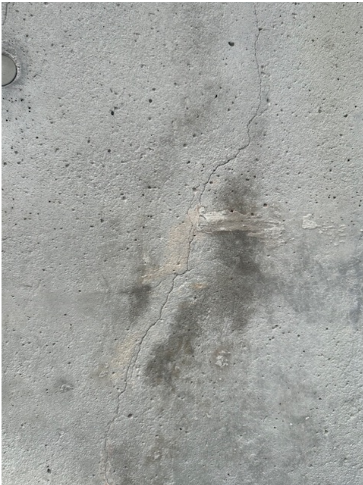
Foto 13b Tuvastatud pragu parkla sissesõidu tunneli ja trepistiku seina sees. Tegemist on puhta kujulise mahukahanemispraoga.
