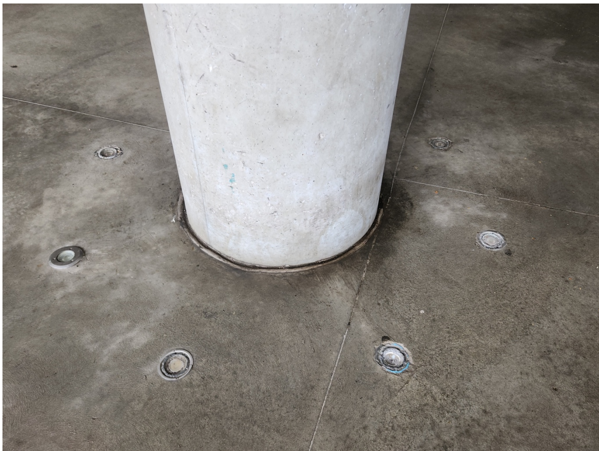
Foto 18 (Kandeposti ja põranda liitumine. Põrand on ülestõusnud).
