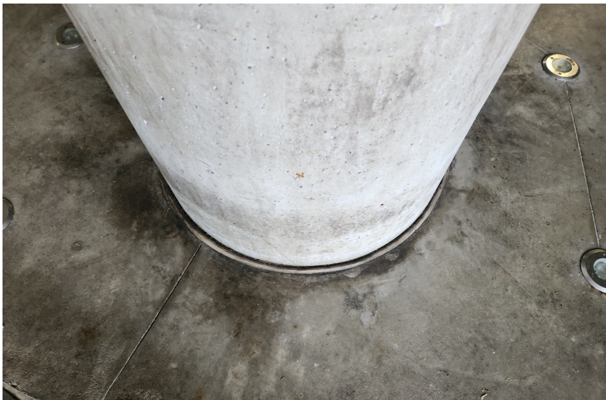
Foto 19 (Kandeposti ja põranda liitumine. Põrand on ülestõusnud).
