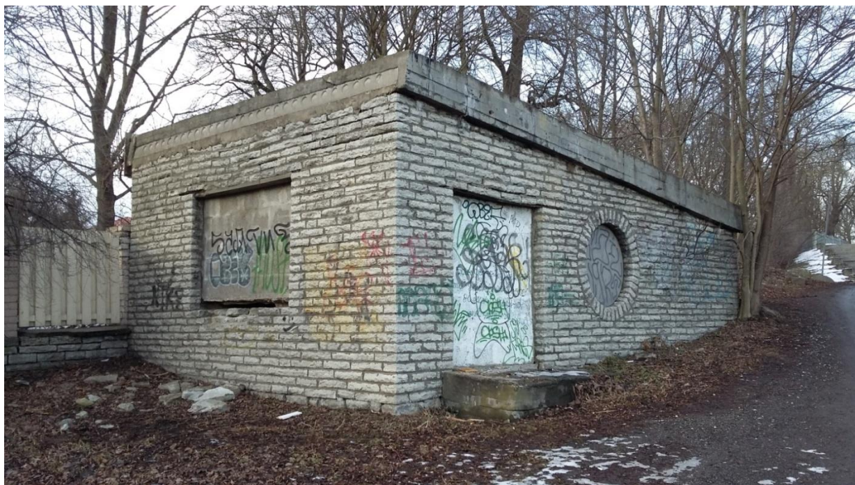
Tuvi pargi servas olev tunneli pääsla on millalgi kaetud sobimatute betoonpaneelidega. Autori foto 2017
