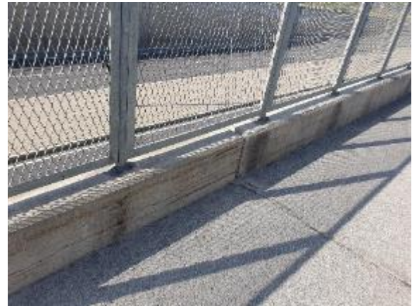
Tugimüür || Tugimüürile on tali hooldest ladestunud roostet.
