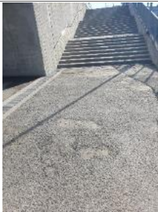
Tunneli põrand || Tunneli ava ja treppi ees asfaldi pind pindmiselt murebenud ja ebatasane.
