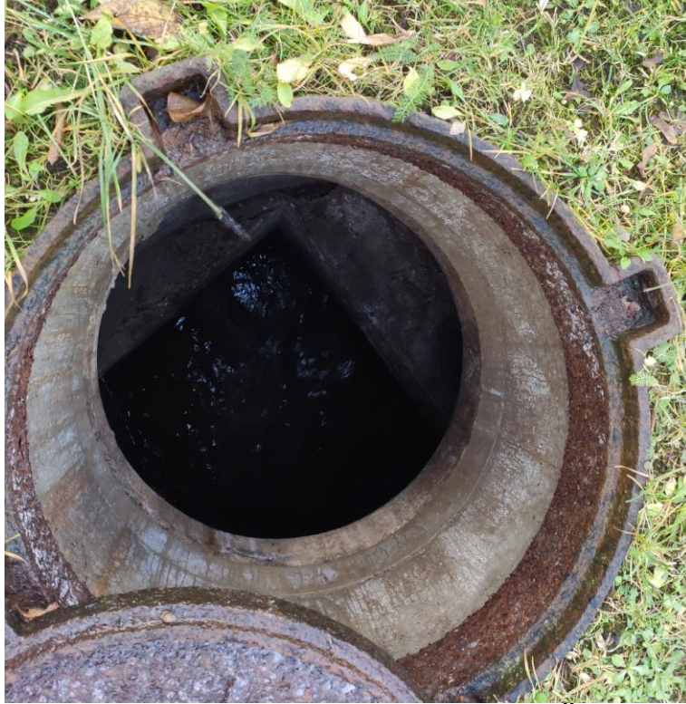
Joonis 3. Russalka sademeveetrassi kaev 23.11.2020 (foto ELLE OÜ)
