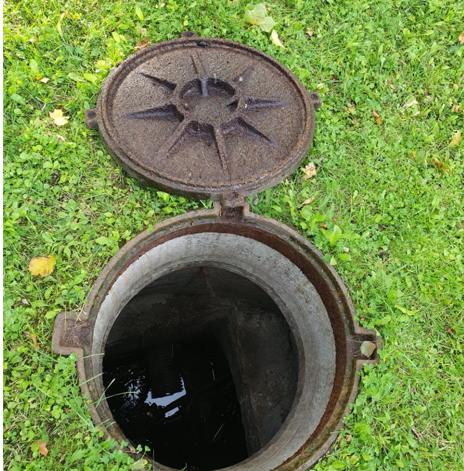
Joonis 5 Russalka sademeveetrassi kaev 14.09.2021 (foto ELLE OÜ)
