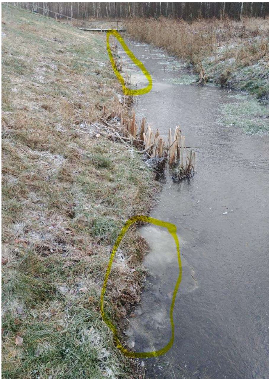
Foto 6. Nõlvast välja kiilduv nõrgvesi
