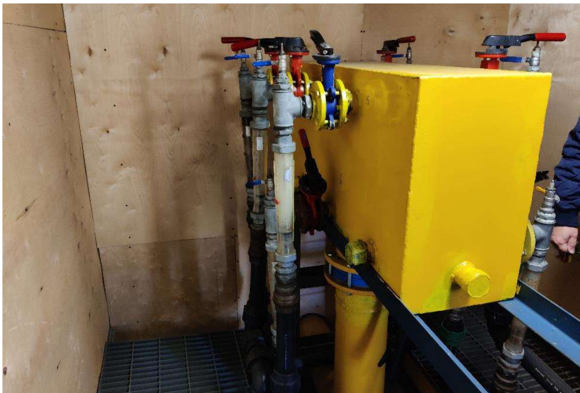
Foto 11. Gaasi reguleerjaama sisevaade
