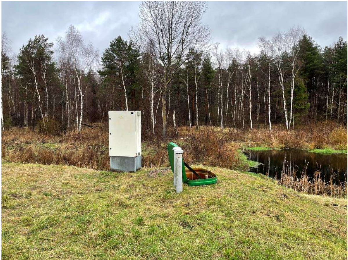
Foto 3. Vaade pumplale PS-1
