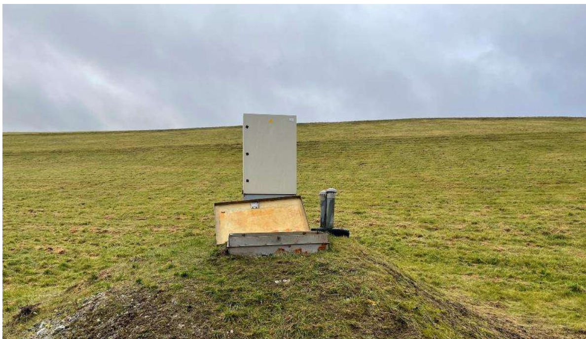
Foto 6. Vaade pumplale PS-2
