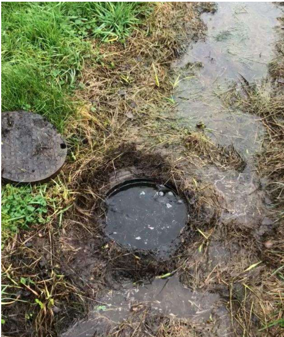
Foto 13. Nõrgvesi voolab drenaažikaevust sisemisse piirdekraavi
