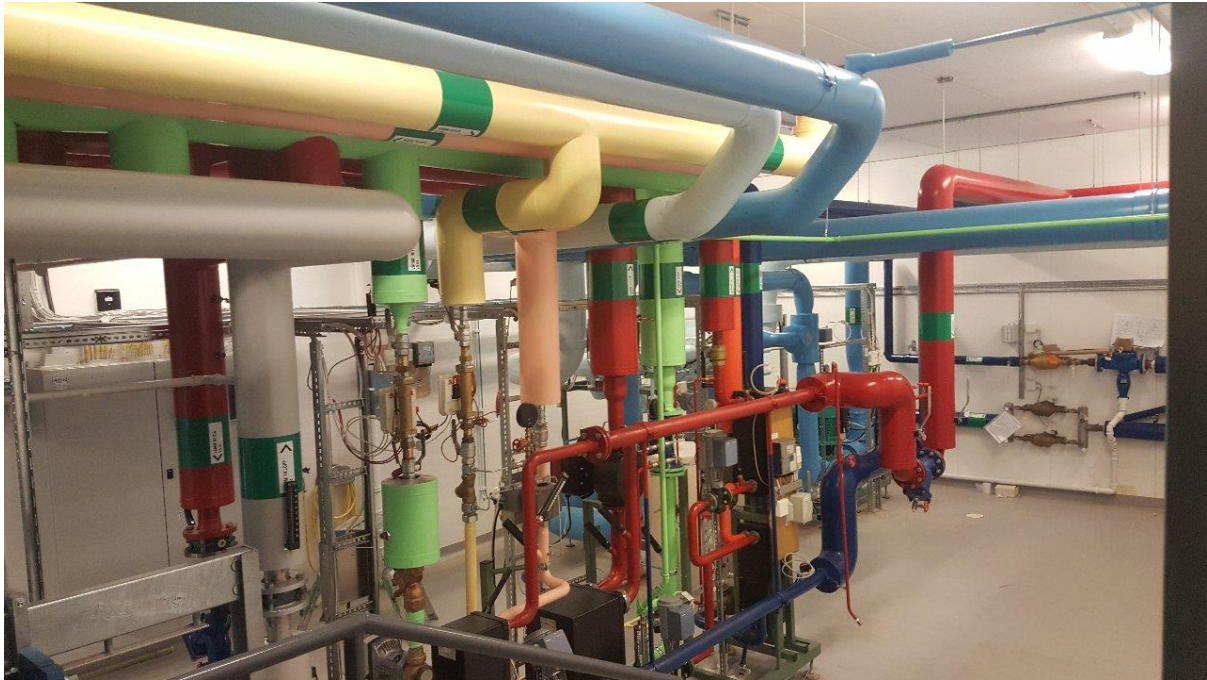
Joonis 2.11. Tüüpiline jahutussõlm (Göteborg Energi) [10]
