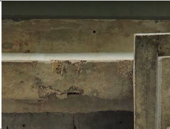
Sõidutee kohal tala tõmbetsoonis murenenud
