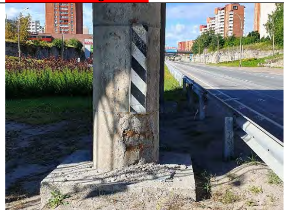
Sõidutee soolvesi kahjustab sambaposte
