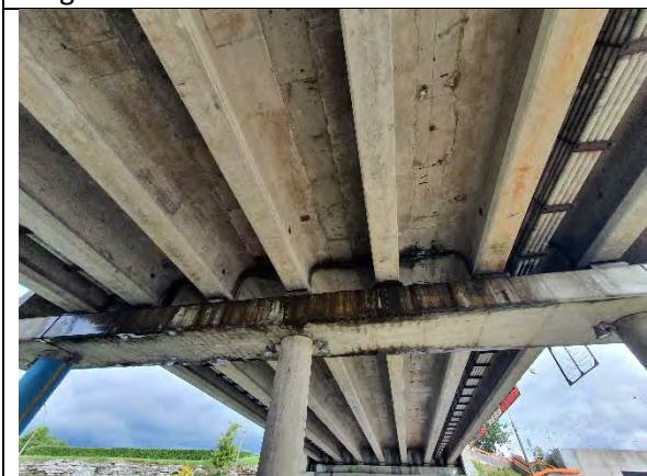
Lekkivad vuugid põhjustavad betoonpindade kahjustusi
