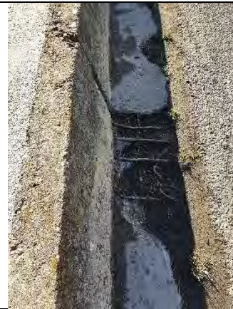
Armatuur paljastunud betoon pörkepiiretel
