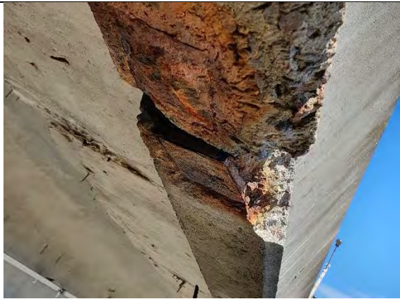
Servaprusside leke põhjustab armatuuri korrosiooni
