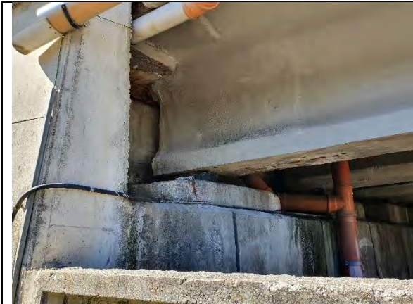
Lekkiv vuuk põhjustab tugiosade ja tala otsade kahjustusi
