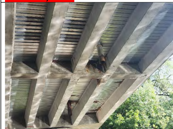
Hüdroisolatsiooni leke põhjustab tekiplaadi roostetamist
