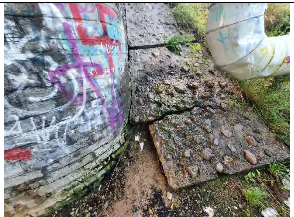
Koonused rohtunud ja lagunevad
