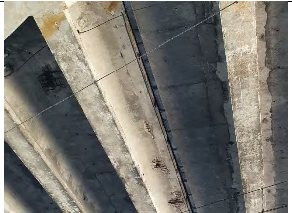
Armatuuri kaitsekihi ebapiisav paksus, betooni murenemine raudtee kohal
