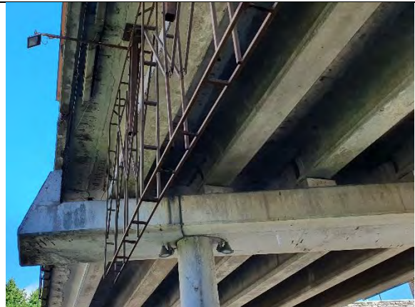
Niiskuskahjustused riigil otstel ning ebapiisav armatuuri kaitsekiht riigil sambapostide vahel
