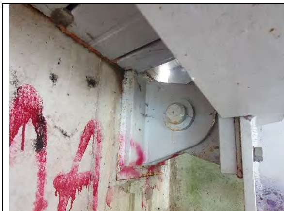
Metallpinnad kohati korrodeerunud
