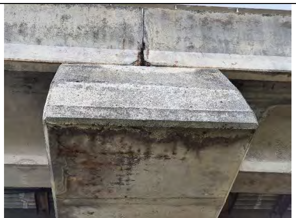
Riigli otsade armatuuri rooste ning betooni kahjustused, tingitud lekkivast vuugist
