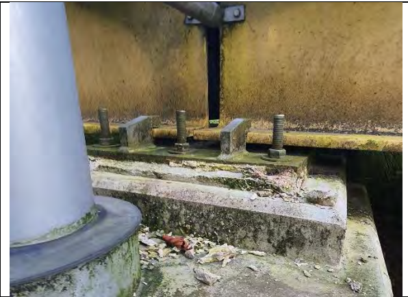
Tugipatjade betoon murenenud
