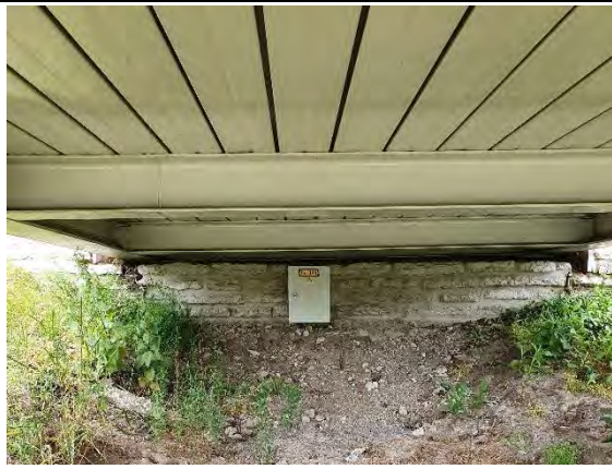
Vähesed niiskuskahjustused kandesammastel
