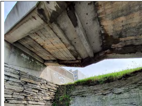
Trepikonstruktsioonid Lekivad ja roostetavad
