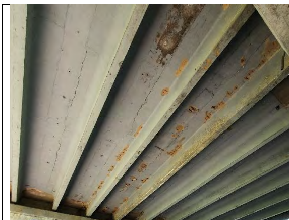
Hüdroisolatsioonileke põhjustab talade kahjustusi
