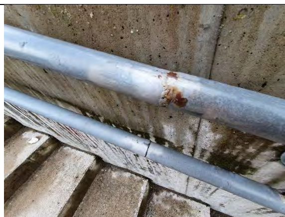
Trepi käsipuud korrodeerunud
