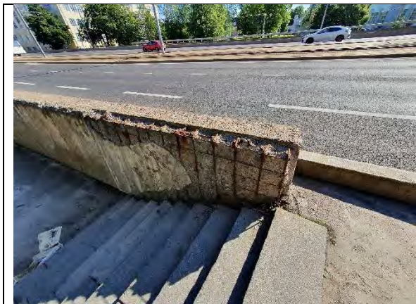
Piirete armatuur korrodeerunud ning paljastunud
