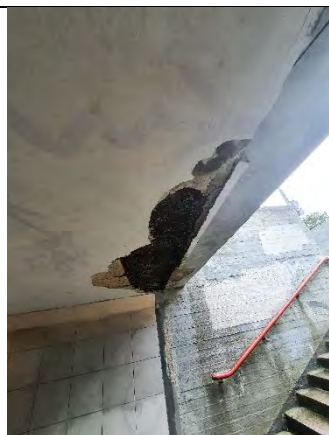
Veelekked põhjustavad armatuuri korrosiooni
