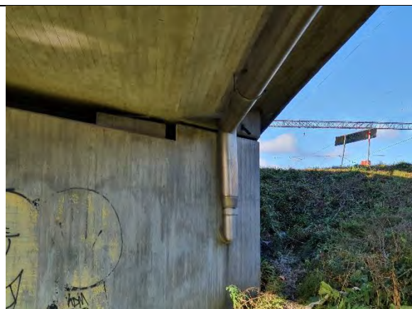
Joatorurenni keevituskohad korrodeerunud
