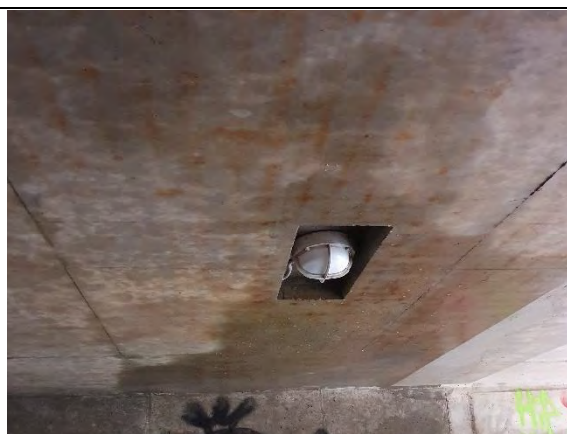
Hüdroisolatsiooni leke põhjustab tunneli lae armatuuri korrosiooni
