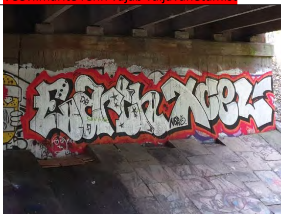
Koonusekindlustuse plaadid vajunud ning osaliselt puudu
