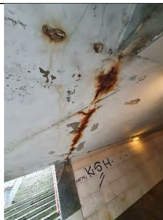
Hüdroisolatsiooni lekked põhjustavad tunneli lae kahjustusi
