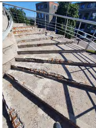
Trepikonstruktsioonid korrodeerunud ning armatuur paljastunud
