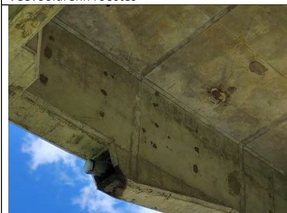
Lokaalsed hüdroisolatsiooni lekked
