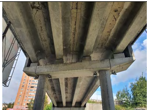
Hüdroisolatsiooni lekkest põhjustatud tekiplaadi kahjustused
