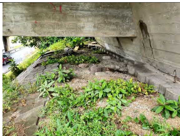
Koonusekivide puudumine ning koonuste rohtumine
