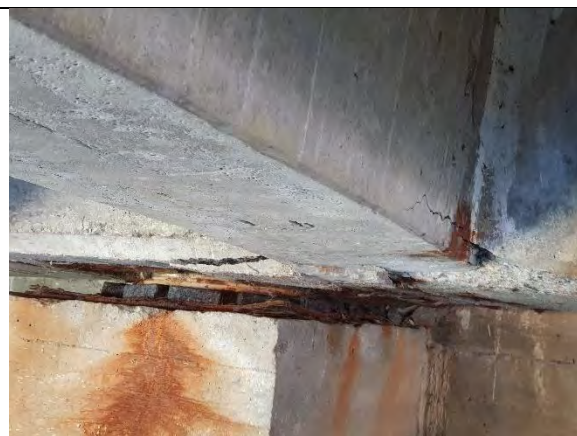
Tugiosade ja talaotste kahjustused lekkivast vuugist
