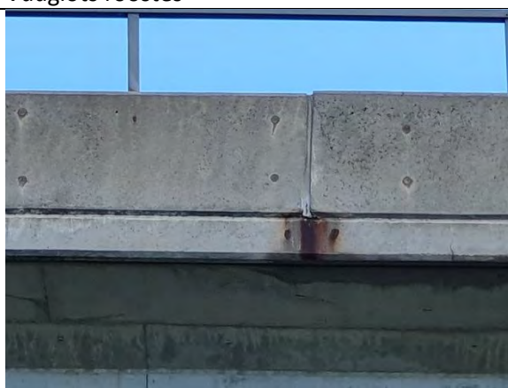
Servaprussi ühenduskohad lekivad
